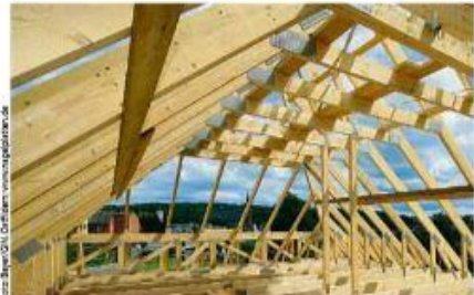
Wohltaum unterm Dach schaffen GIN-Mitgliedsbetriebe wie die Zimmeri Beyer aus Ditzendorf/Hilbringen mit Nagelplattenbindern. Bei diesem Einfamilienhaus besteht das Dachtragwerk aus Strohbindern.
