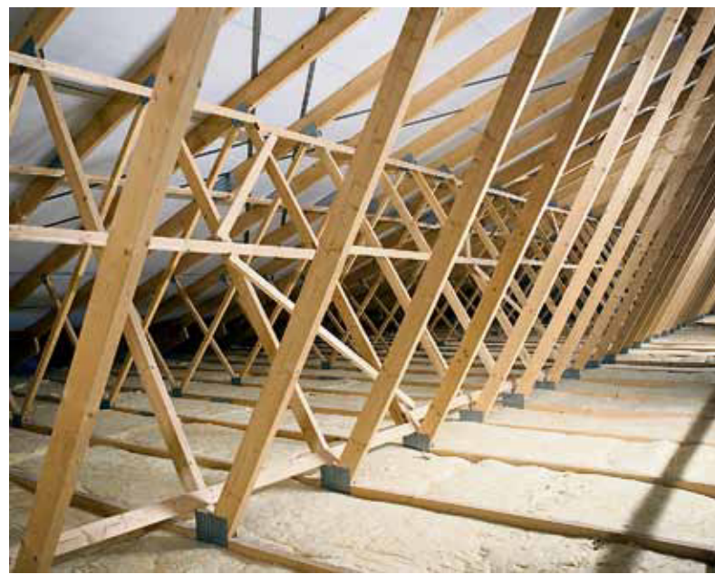
Schutz vor Wind und Wetter: Dachtragwerke aus Nagelplattenbindern sind nachweislich robust.
