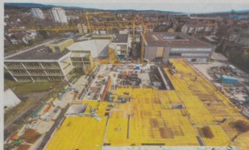
Die Baumaßnahmen am Radolfzeller Berufsschulzentrum finden um den bestehenden Altbau herum und bei laufendem Schulbetrieb statt. Fertigstellung und Inbetriebnahme des südöstlichen Gebäudes erfolgte im letzten Jahr, derzeit werden der Westtrakt und die Sporthalle errichtet.
