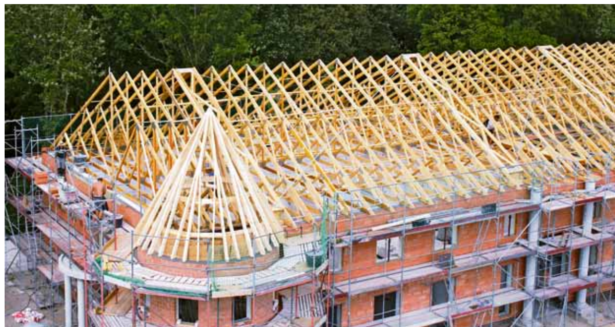
Nagelplattenbinder für Dachtragwerke aller Größen werden von GIN-Mitgliedsfirmen wettergeschützt vorgefertigt und richtfertig auf die Baustelle gebracht.
